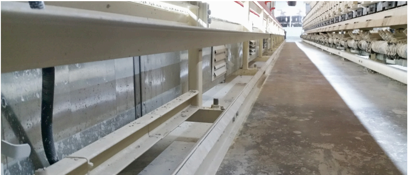
Anti-fog system for spagless bench ~ Impianto anti-fog per banchi di colaggio spagless
